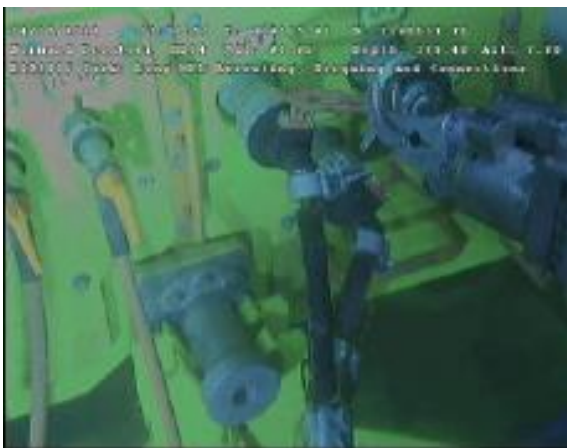
Figur 6-93 HFL UL-18-6002 koblet til LP3
