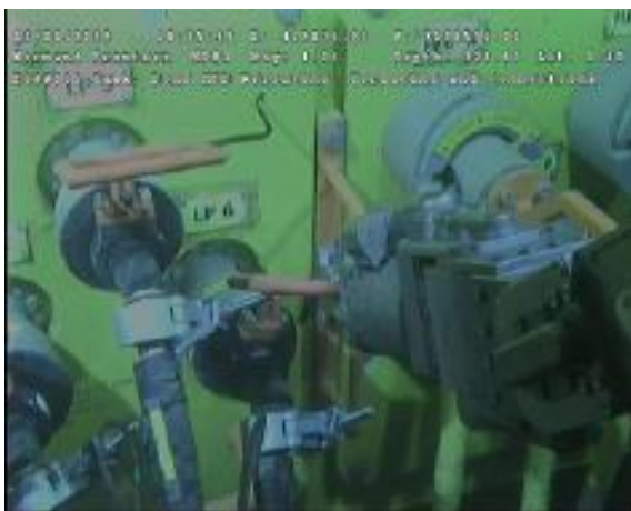
Figur 6-114 HFL UL-18-7034 koblet til LP6
