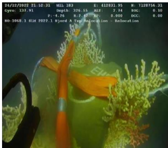
Figur 6-157 Slings montert på transponderstøtten
