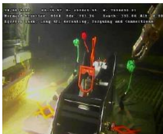
Figur 6-84 Momentverktøy installert på HFL UL-18-6003
