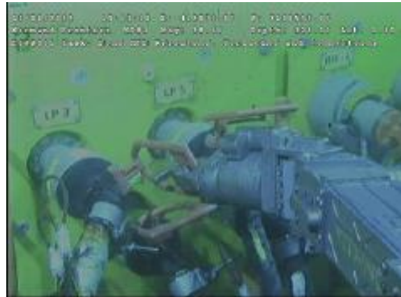
Figur 6-111 HFL UL-18-7032 koblet til LP3
