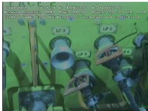
Figur 6-113 HFL UL-18-7035 koblet til LP5
