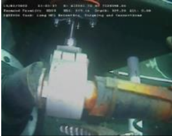
Figur 6-104 Anti Rotasjons klemme installert på HFL UL-18-7033
